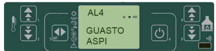
fig. 43 tableau de commande - alarme du ventilateur d'aspiration des fumées
