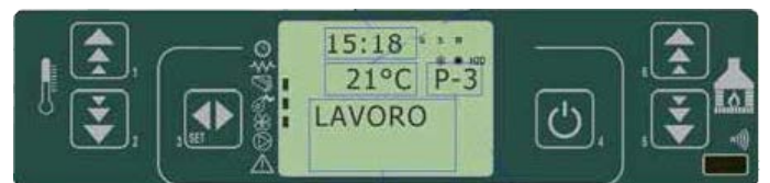
fig. 25 painel de comandos - condição de funcionamento
