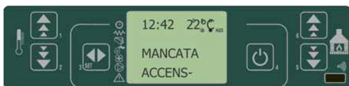
fig. 35 painel de comandos - alarme por falha no acendimento
