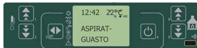
fig. 39 painel de comandos - alarme ventilador de aspiração de fumos
