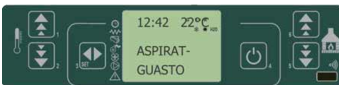
fig. 39 tableau de commande - alarme du ventilateur d'aspiration des fumées
